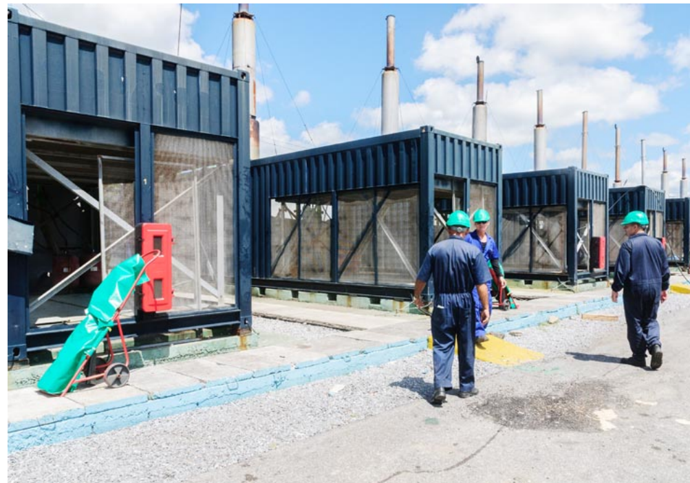
La Revolución Energética es una conquista de nuestro pueblo; y si bien es cierto que estos equipos electrógenos no funcionaron a plena capacidad durante estos días, sin ellos toda la provincia hubiese estado apagada a tiempo completo. Foto de Jaliosky Ajete Rabeiro
