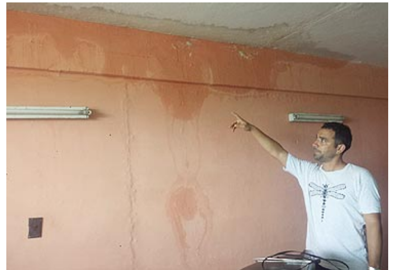
La vivienda de Andrés Raciél González es una de las más afectadas
