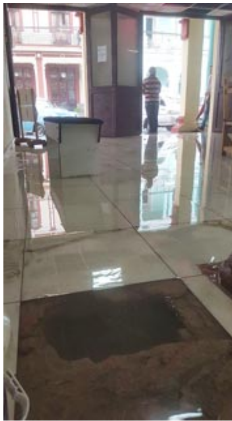
Los registros tupidos provocaron la inundación del local
