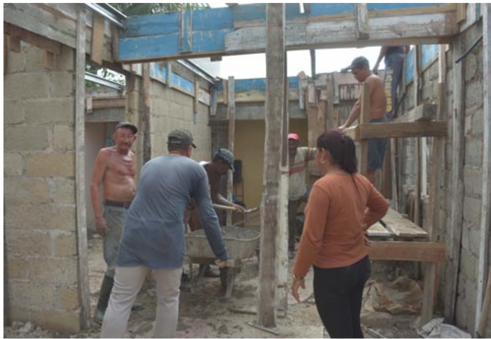
La construcción de viviendas mediante el programa de subsidios permite paulatinamente ir ofreciendo solución a uno de los problemas más acuciantes
