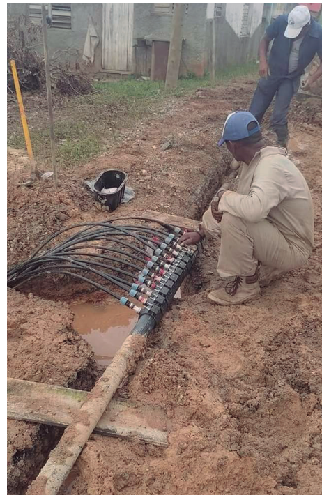
Con una red de 400 metros de tubería de 75 milímetros y 64 viviendas conectadas se trabaja por reducir los ciclos de agua en Minas de Matahambre. Foto tomada del perfil de Facebook de la Empresa de Acueducto y Alcantarillado
