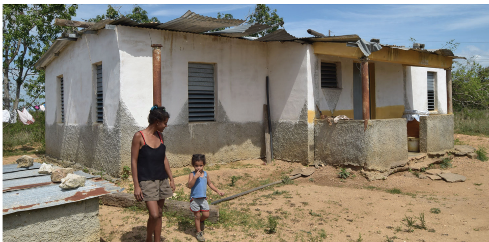
Algunas de las viviendas con pérdida parcial o total de techo pertenecen a personas en situación de vulnerabilidad
