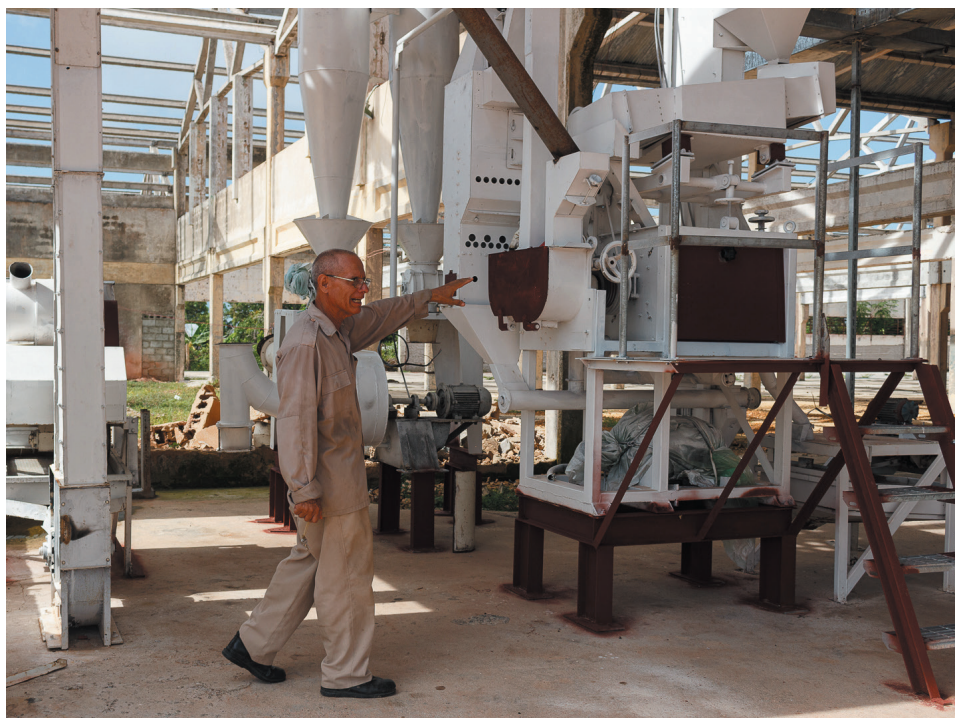
Algunos objetos de obra como es el caso del molino ya están próximos a ponerse en marcha
