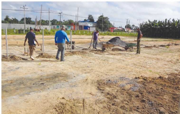
Para finales de diciembre debe concluir el montaje de cuatro túneles con capacidad para 250 000 posturas cada uno
