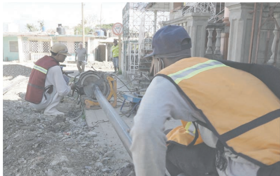
La rehabilitación de redes fue una de las inversiones en la que se centraron esfuerzos durante el 2024. Foto de Pedro Paredes Hernández
